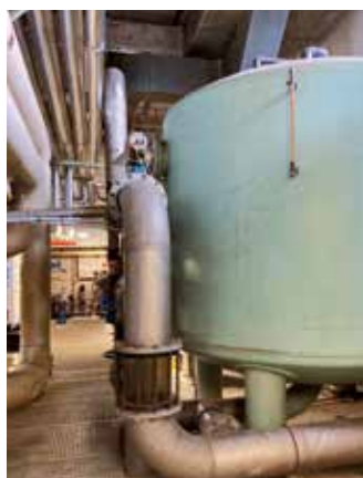
Die Technik des 1978 eröffneten Hallenbades ist mittlerweile stark veraltet und störanfällig, Ersatzteile sind kaum mehr zu bekommen.
